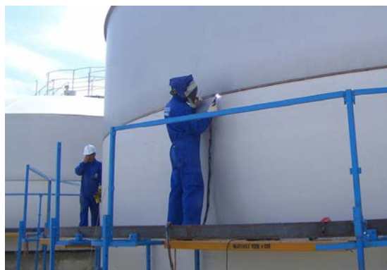
Trabajo en exteriores de soldeo de tanques de acero inoxidable – una aplicación típica de los hilos tubulares rellenos de fundente para soldeo en todas posiciones de Böhler Welding. El metal base de los tanques es 1.4162 y se suelda con FOXcore 2307-T1.
